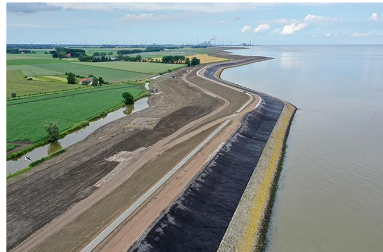
Aanleg fietspad Kiek over Diek, op kruin van de dijk tussen Delfzijl en Eemshaven
